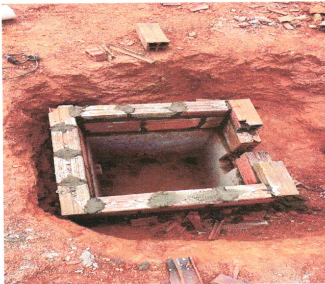
FOTO 146: CAIXA DE PASSAGEM ESGOTO
