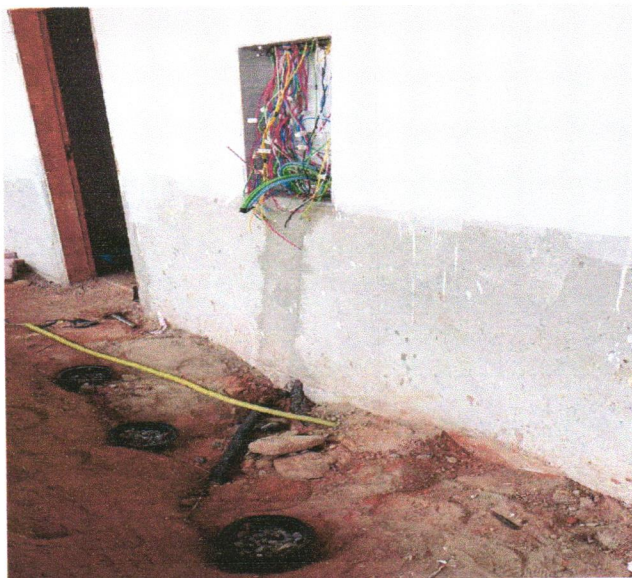
FOTO 152: INSTALAÇÃO ELÉTRICA – QUADRO E ATERRAMENTO
