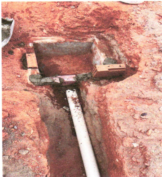
FOTO 145: CAIXA DE PASSAGEM ESGOTO
